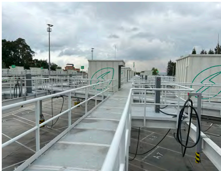
Supercarregadores em La Rolita distribuem energia para 93 carregadores dispensadores que recarregam as baterias dos ônibus na garagem
